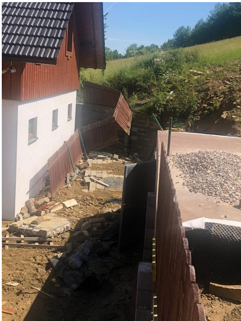
Poškození majetku u domu čp. 83 - Penzion Nivy – Jandovi
